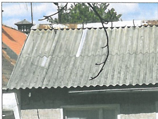
Fot.1 Płyty azbestowo-cementowe faliste
