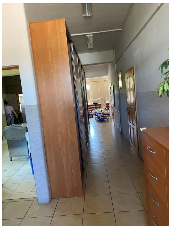
Zdj. 5- palny wystrój wnętrz na drodze ewakuacyjnej – do usunięcia.
