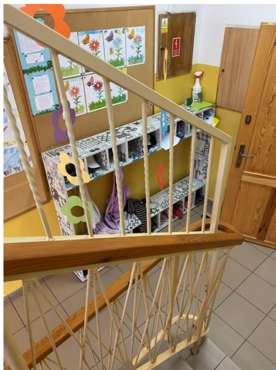
Zdj. 4- palny wystrój wnętrz na drodze ewakuacyjnej – do usunięcia.
