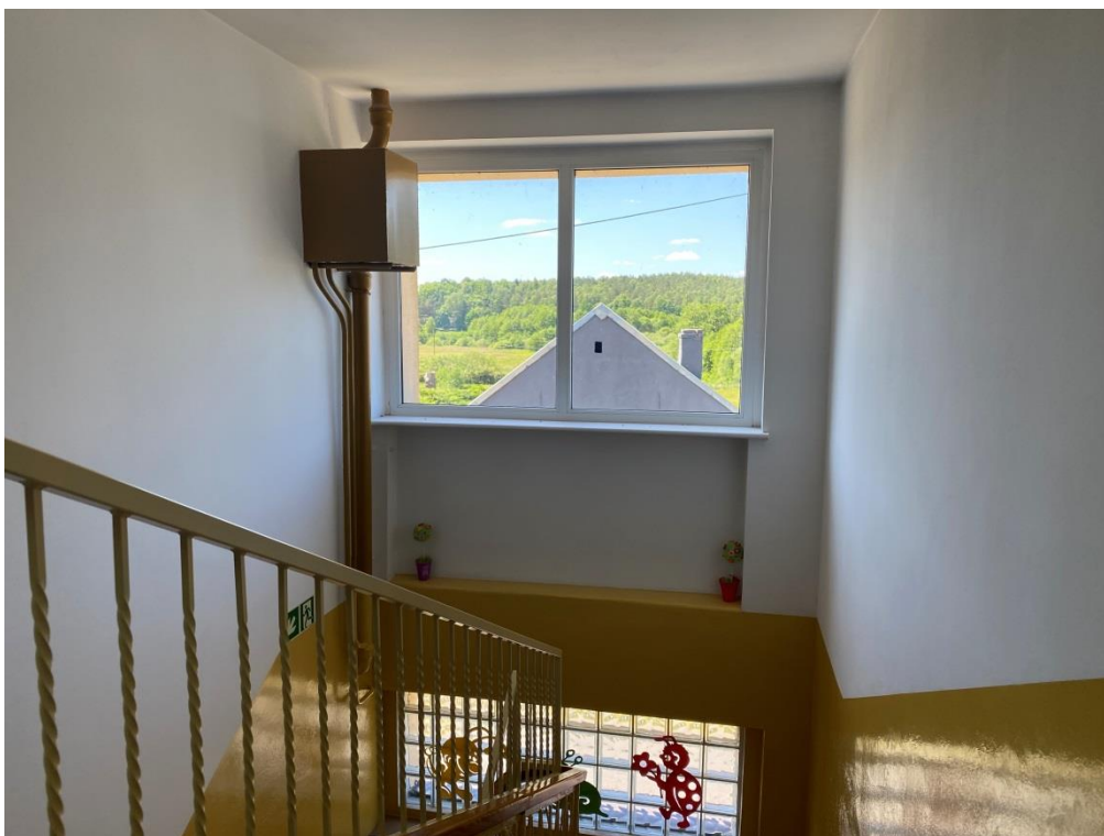
Zdj. 1 – okno na I piętrze do wymiany na okno oddymiające do oddymiania grawitacyjnego klatki schodowej
