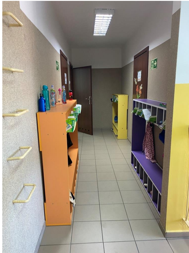
Zdj. 3- palny wystroj wnętrz na drodze ewakuacyjnej – do usunięcia.
